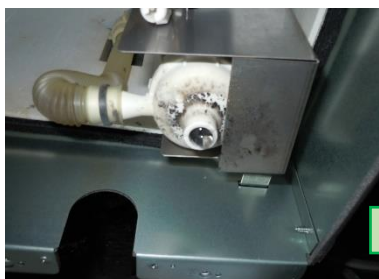
【ドレンポンプ清掃前】
